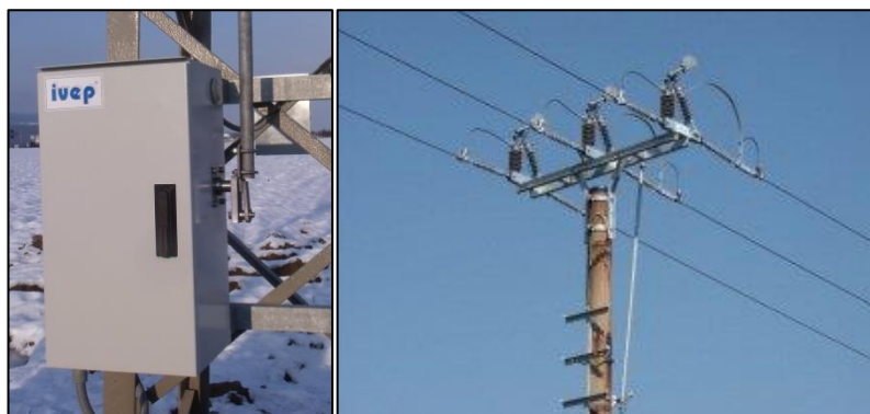
Obrázek 10: Dálkově ovládaný úsekový odpínač (Zdroj: IVEP)
