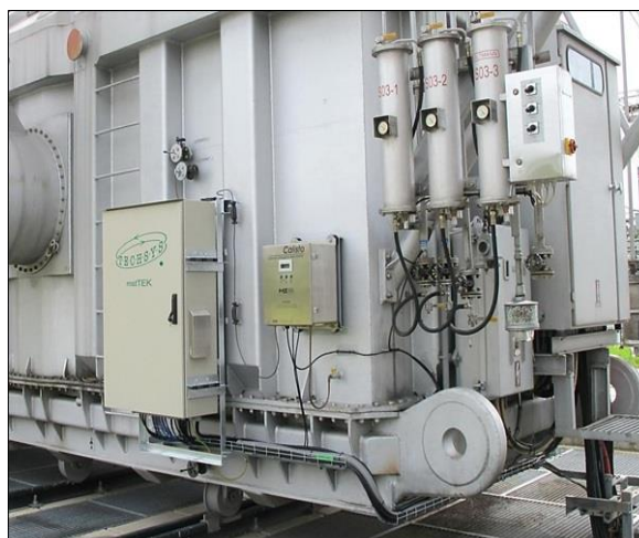
Obrázek 6: Monitorovací systém transformátorů TECHSYS (Zdroj: TECHSYS)
