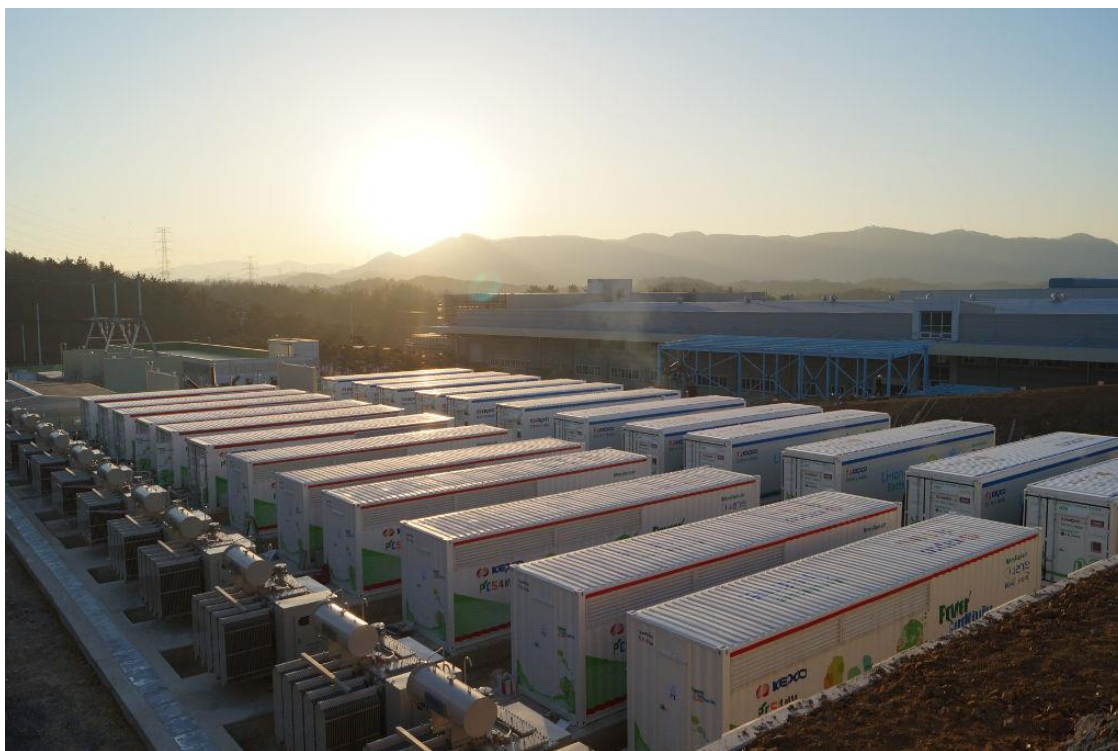
Zásobník elektrické energie v roli regulátoru frekvence.
