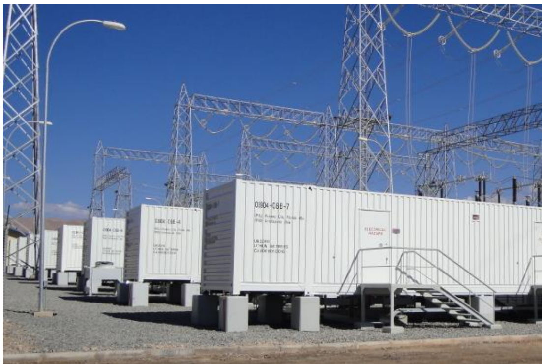
Akumulace elektrické energie je náročná na zastavěnou plochu.
